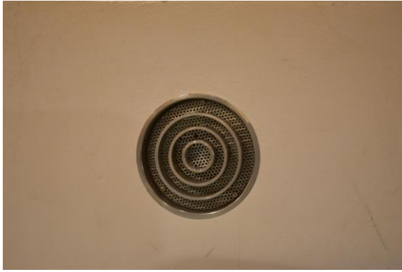
Abb. 2.1.122 Ratssaal, integrierter Lautsprecher in der Brüstungswand, Foto: strebewerk. 2018
