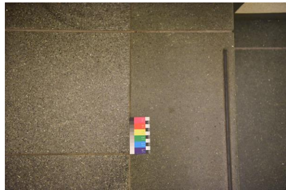
Abb. 2.1.32 Treppenhaus, leichter Farb- und Strukturunterschied zwischen den Platten der Treppenpodeste und den Stufen, Foto: strebewerk. 2018
