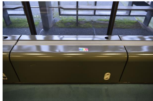
Abb. 2.1.135 Empfangsraum, Klimatelement, Foto: strebewerk. 2018
