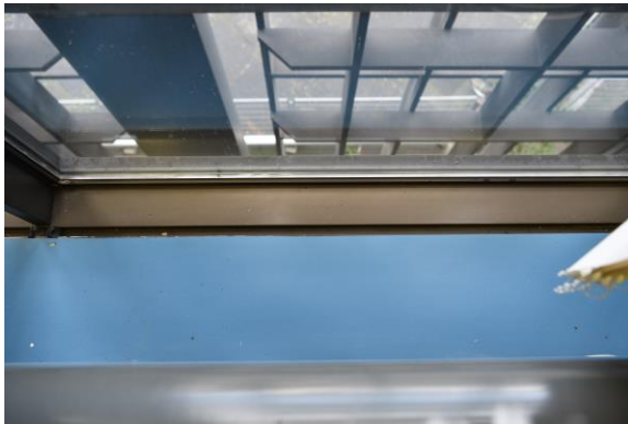
Abb. 2.1.21 Fenster mit ausgeblichener Linoleumbahn vor der Außenfassade, Foto: strebewerk. 2018
