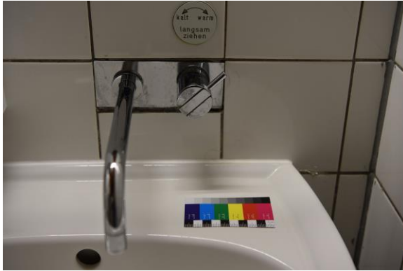
Abb. 2.1.141 Armatur „Vola“, Foto: strebewerk. 2018
