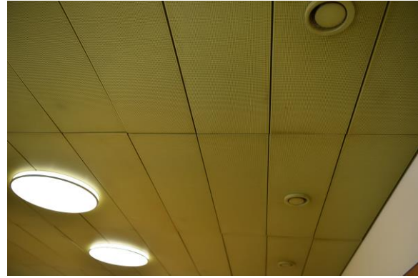
Abb. 2.1.10 Büro, abgehängte Decke mit grünen Paneelen, Beleuchtung und Abluftglocken, Foto: strebewerk. 2018
