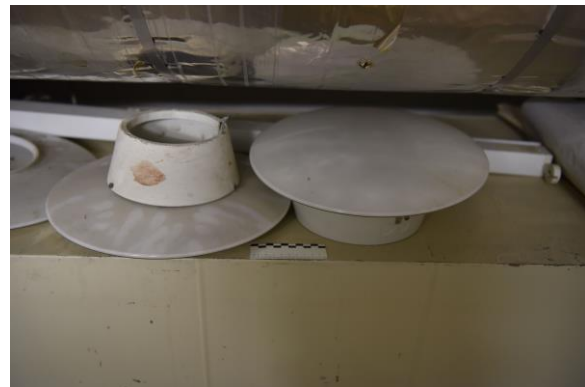
Abb. 2.1.101 Materiallager, Glaslampen, Foto: strebewerk. 2018
