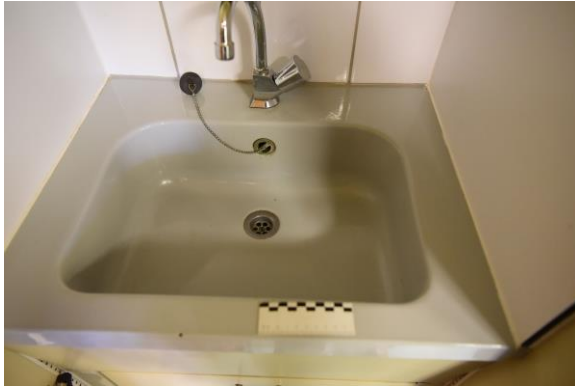
Abb. 2.1.147 Waschbecken in Büroschrank, Foto: strebewerk. 2018
