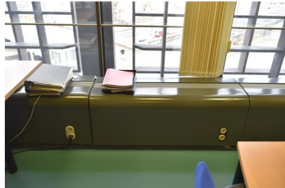
Abb. 2.1.133 Büroraum, Klimatelement, Foto: strebewerk. 2018
