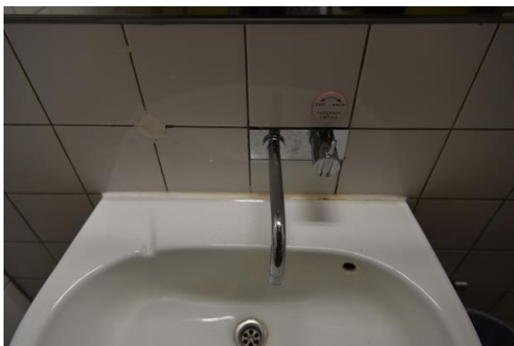
Abb. 2.1.145 Armatur „Vola“, Aufsicht, Foto: strebewerk. 2018
