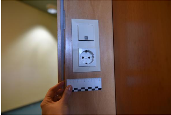
Abb. 2.1.128 Büro, Lichtschalter, Foto: strebewerk. 2018
