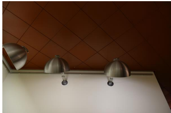
Abb. 2.1.105 Foyer, Wandstrahler, Foto: strebewerk. 2018
