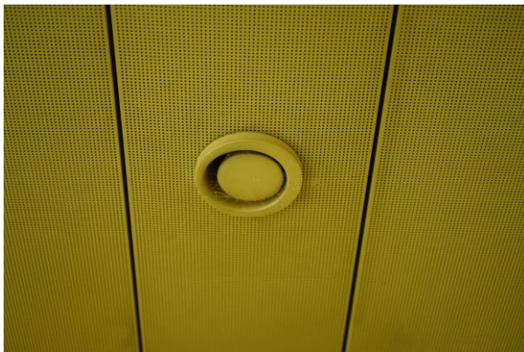
Abb. 2.1.11 Lochblechpaneel mit integrierter Abluftglocken, Foto: strebewerk. 2018
