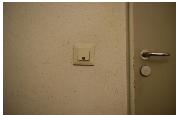
Abb. 2.1.127 Treppenhaus, Lichtschalter, Foto: strebewerk. 2018
