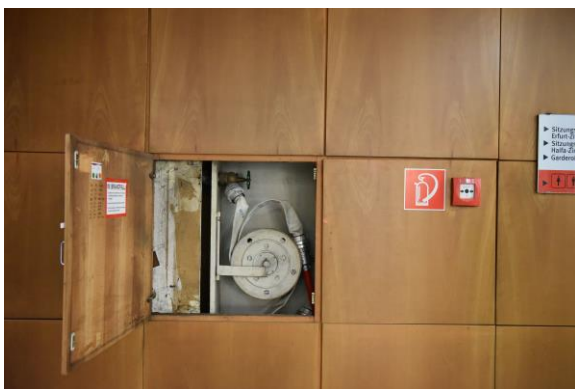
Abb. 2.1.151 Feuerlöschschlauch mit Schlauchhaspel, Foto: strebewerk. 2018
