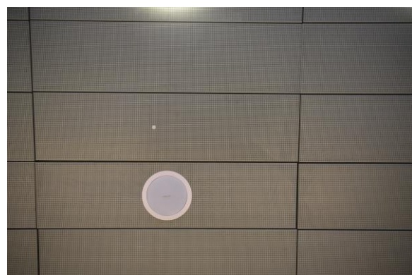
Abb. 2.1.02 Langrechteckiges Deckenpaneel in Weiß, Flur Erdgeschoss, Leuchte ersetzt, Foto: strebewerk. 2018
