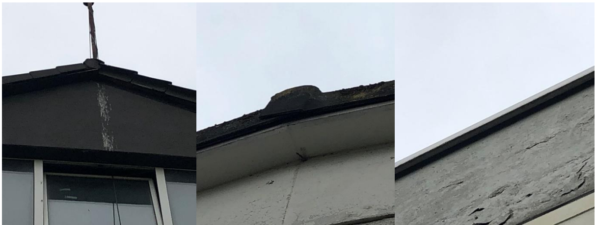
Abb. 6: Spalten an Gebäuden als potenzielle Fledermausquartiere im Plangebiet
